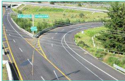
Falta señalamiento Delineador de curva
