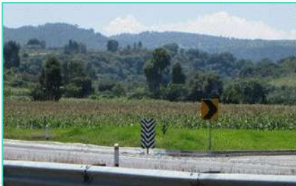
Señalamiento que no cumple las especificaciones de norma
